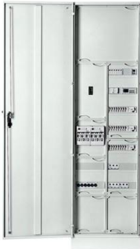
Rozdzielnica budynkowa 630A
