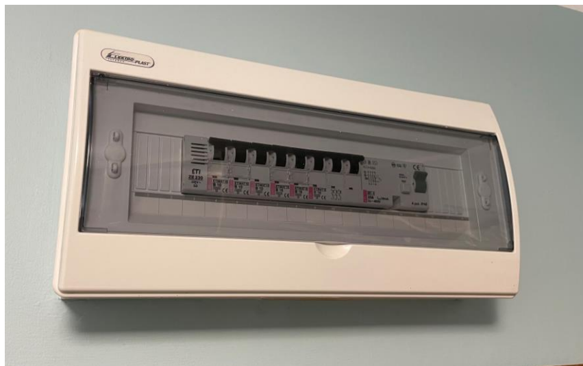
Rozdzielnica domowa 25A
